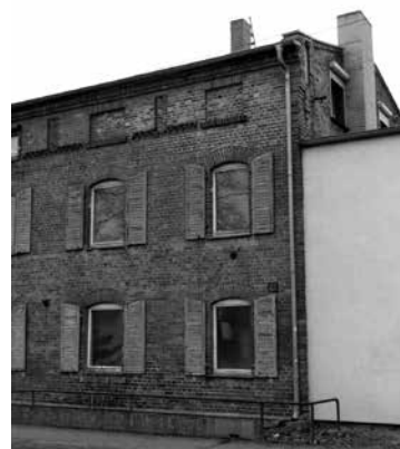
Abbildung 8: Spremberger Str. 21. Der Granateneinschlag ist am Mauerwerk immer noch zu erkennen; Foto: Uwe Kulke, 2017 (nach der Sanierung 2024 nicht mehr erkennbar)
